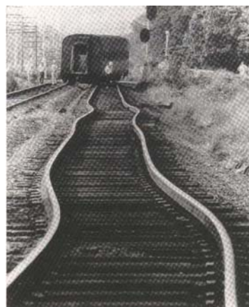
Fig. 1 Deformazione causata dalla dilatazione termica.
