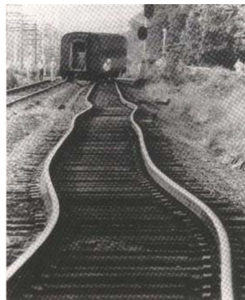
Fig. 1 Deformazione causata dalla dilatazione termica.
